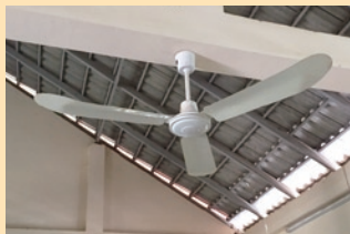
図書館に設置した扇風機
