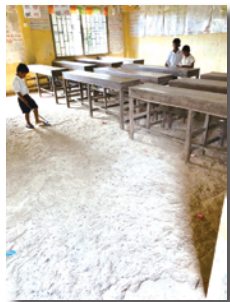
教室の 床の損傷が 目立つ
