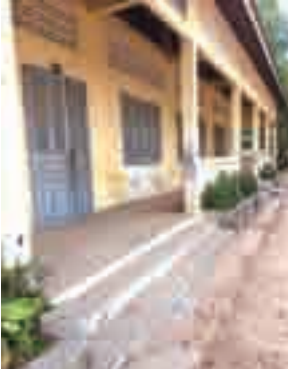
外壁塗装が必要な平和小学校校舎
